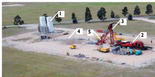
Rys. 7. System uzbrojenia otworu iniekcyjnego instalacji UCG [1] Oznaczenia: 1 – zbiorniki z mediami technologicznymi; 2- urządzenie do uzbrajania otworów; 3 – maszt do wprowadzania rur iniekcyjnych; 4 – system mieszania gazów iniekcyjnych; 5 – głowica otworu iniekcyjnego
